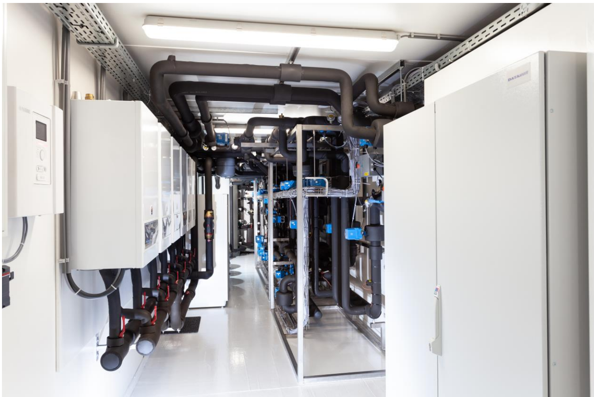
Foto 8.4-1: Technische installatie bij het Ecovat Systeem in Uden.
